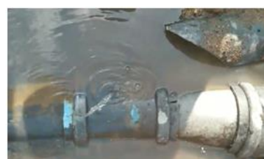
Figura 3: Perdas reais em tubulação no Bairro São José, Juazeiro do Norte - CE. Fonte: A autora, 2024.
