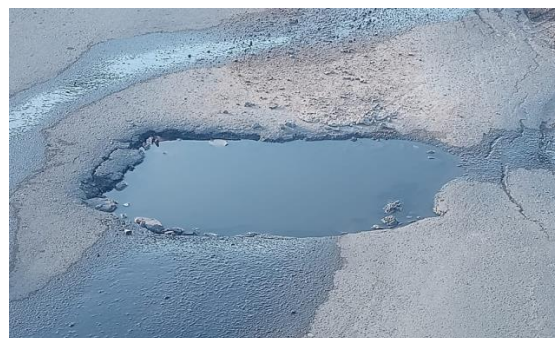
Figura 2: Perda reais em ruas asfaltadas do Bairro São José, Juazeiro do Norte -CE Fonte: A autora, 2024.
