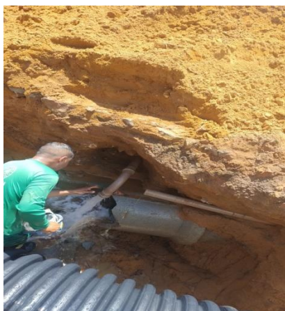
Figura 4: Rupturas na rede de distribuição no Bairro São José, Juazeiro do Norte -CE Fonte: A autora, 2024.
